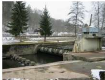
Abbildung 2.2: Das Wehr der Anlage Schickhardt / Innobelt
