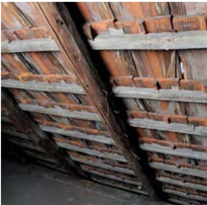
Oben alles dicht? Hier muss gedämmt werden.
