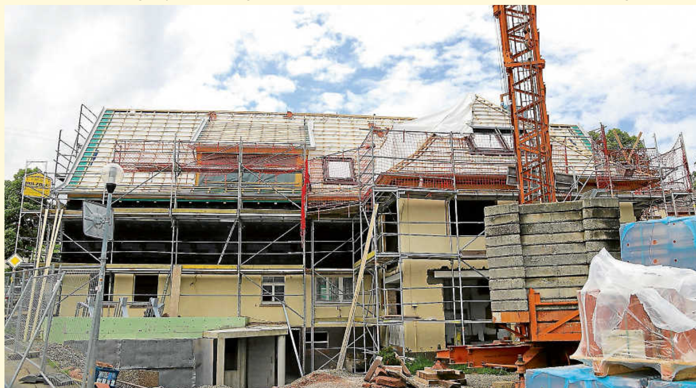
Das Bohnenberger-Areal in Bad Teinach-Zavelstein wird aktuell mit ELR-Mitteln umgebaut. Es entstehen fünf neue Wohneinheiten und eine Ladeneinheit. Foto: Jörg Widmann
